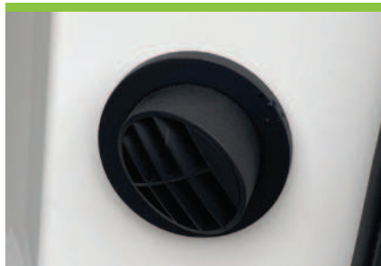
6.23 Ventilator D 250 mm (Zuluft) + Rosette D 250 mm (Abluft) + Sensor
